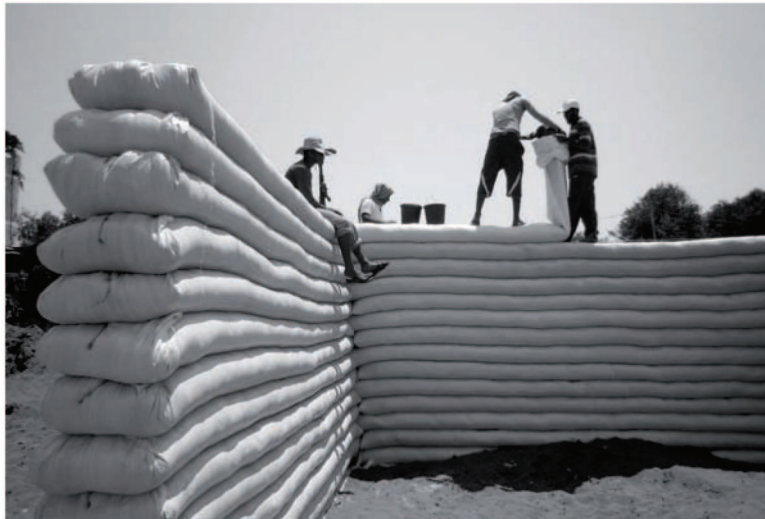
Costruzione della scuola a Um al Nasser, Striscia di Gaza, 2011. Tecnica Earthbags. / Construction of the School in Um al Nasser, Gaza Strip, 2011. Earthbags Technique.
